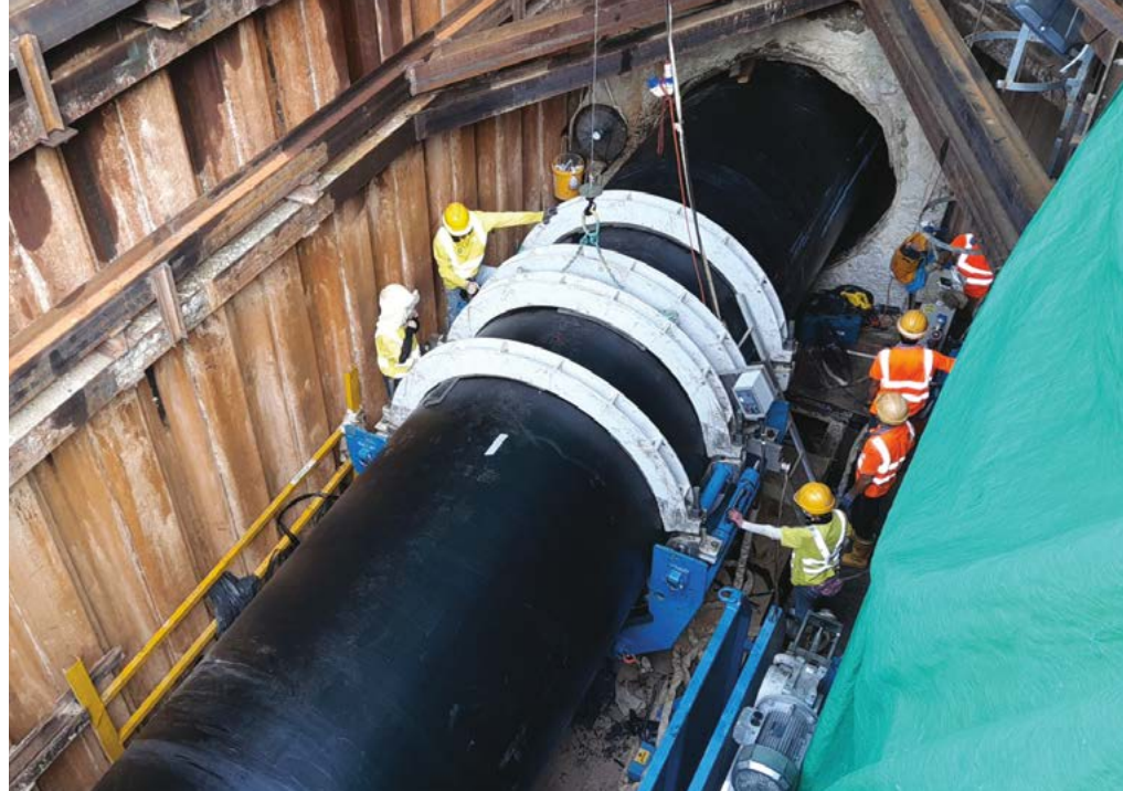
▲東江水水管P4改善工程——利用內套喉管法將聚乙烯喉管置入舊水管以進行大型復修工程。
