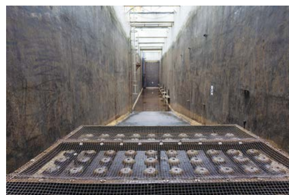
▲ 木湖原水抽水站維修期間的內部情況，來水槽在運作時內部是注滿水的。
