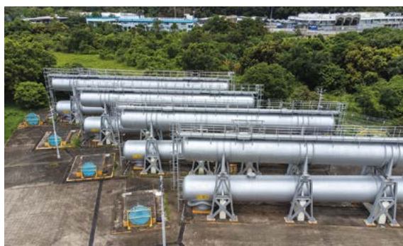
▲ 木湖原水抽水站備有連接東江水輸水管的緩衝缸（又稱風缸），裡面原水和風各佔一半。這個裝置通常設於較多轉彎位的水管，有助減輕因水錘作用引致的壓力急增問題。當水管爆裂而造成管內水壓急降時，風缸內的原水便會補充至水管，以平衡管內水壓，並保護不停運作的水泵。
