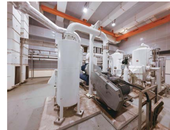
▲ 位於大埔濾水廠的真空採吸製氧機，抽取空氣並將其中的氧氣 (O 2 ) 分離出來。
