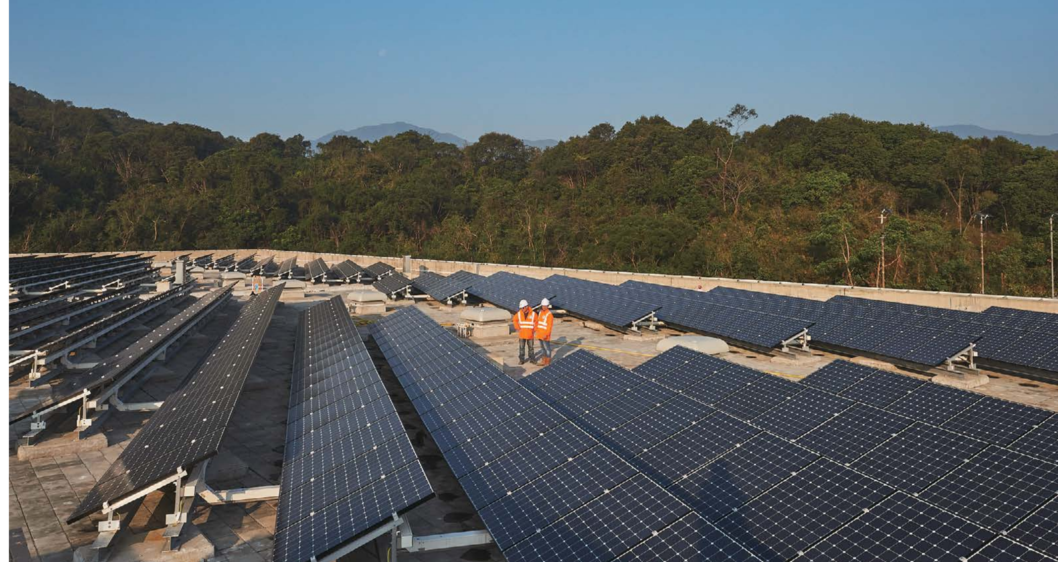
▲ 溶氣浮選池大樓天台的太陽能發電板
