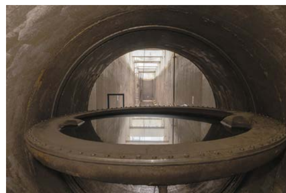
▲ 東江輸水管內部設有蝴蝶形閘掣，透過遙控開關控制輸水流量。
