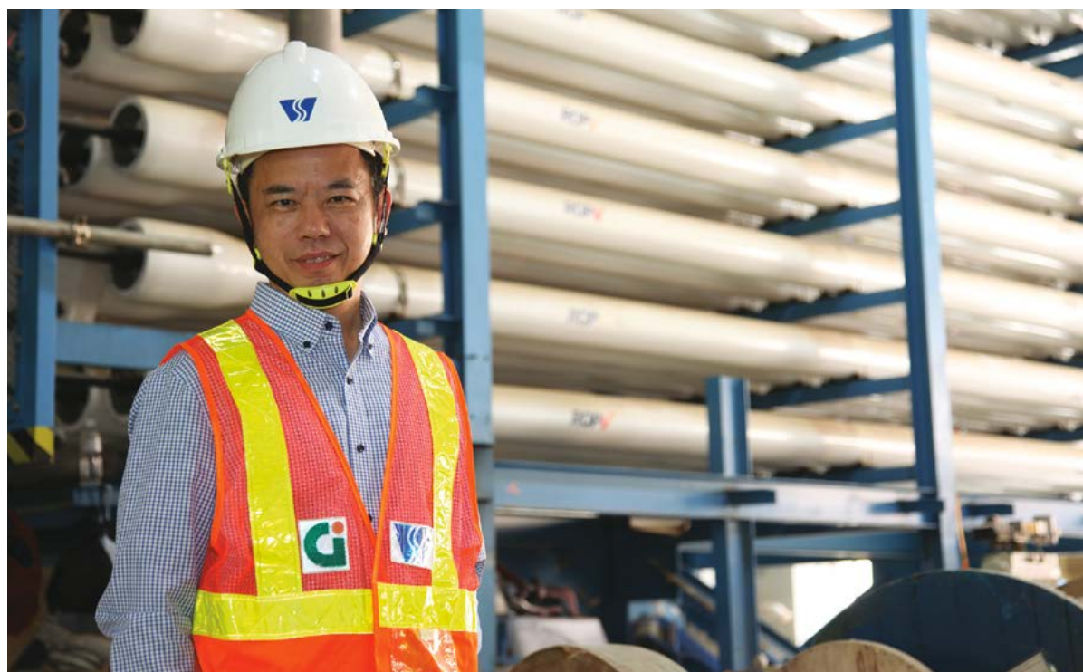
▲ 設計及建設科高級工程師林國泉指，將軍澳海水化淡廠的大型壓力水管組件應用了可供製造及裝配的設計。
