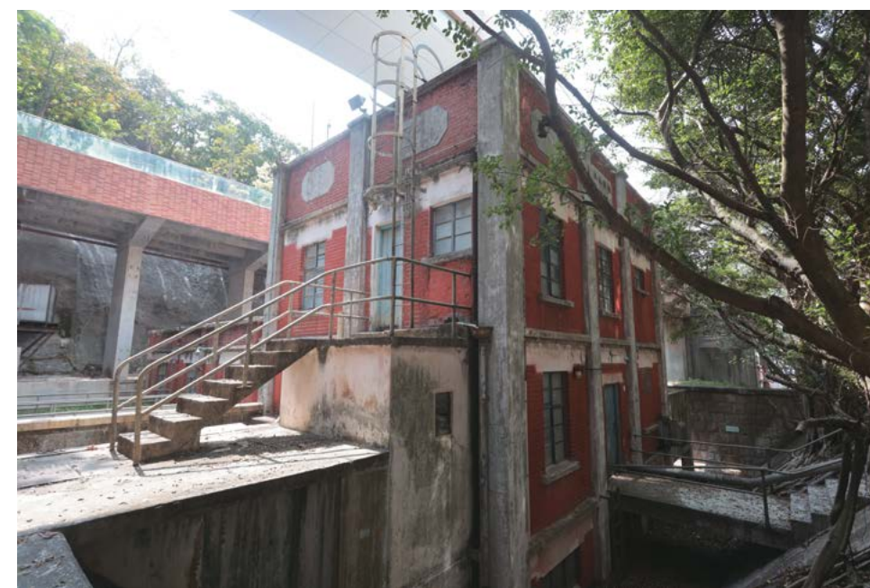
▲ 位於西區配水庫旁的西區抽水站及濾水廠廠房，被評為三級歷史建築物。
