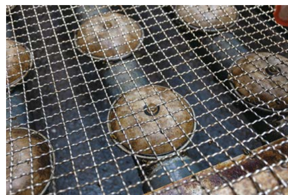
▲ 東江輸水管外設充氧排，透過啟動鼓風機輸送大量空氣，確保來水槽底部的水流動，減少死水區。
