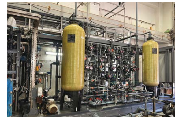
▲ 現場製氯設施
