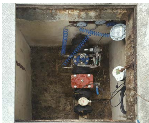
▲ 監測區域錶井內的儀器及設備
