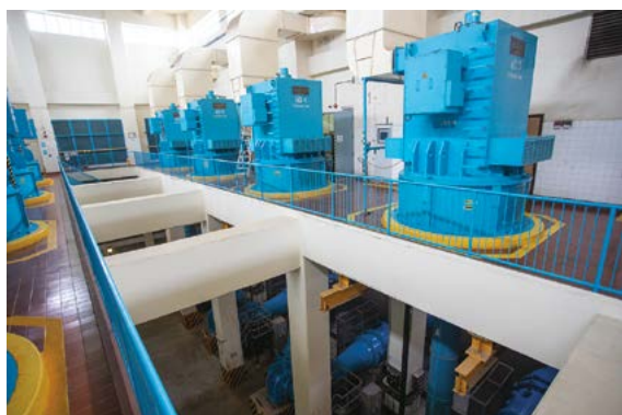
▲ 抽水泵樓高兩層，上層的摩打帶動下層旋轉泵的葉輪產生離心力，帶動原水轉動來輸送東江水。
