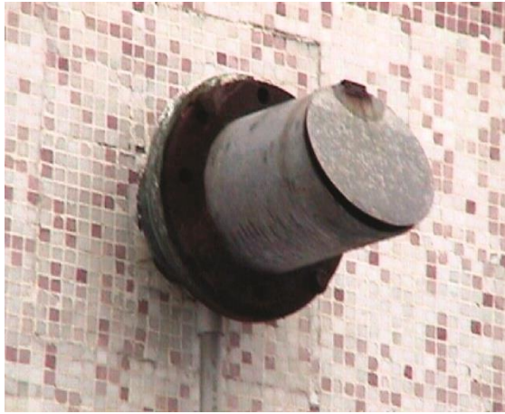
設有自閉封蓋的溢流管
