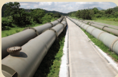
香港輸送東江水的管道
