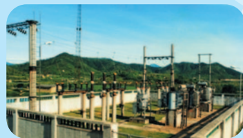
二期擴建工程 — 上埔變電站
