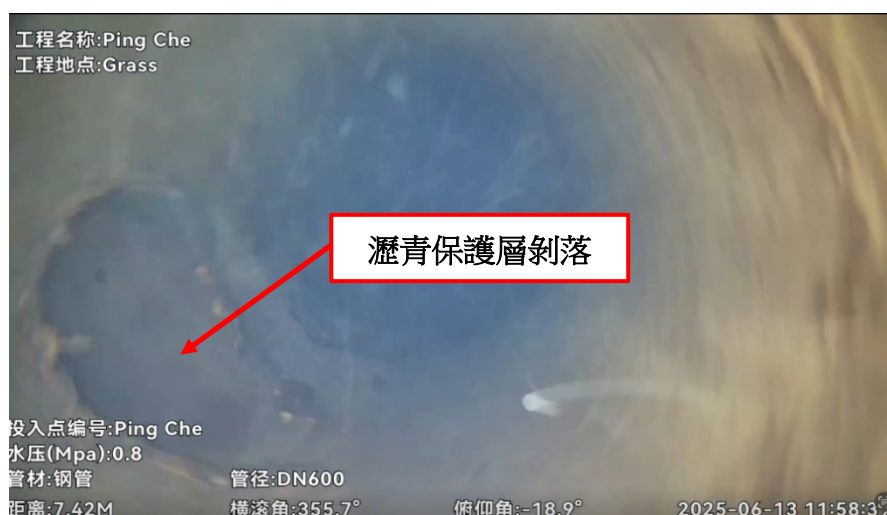
圖 3.5 位於坪輦路一段供水喉管瀝青保護層的剝落情況
