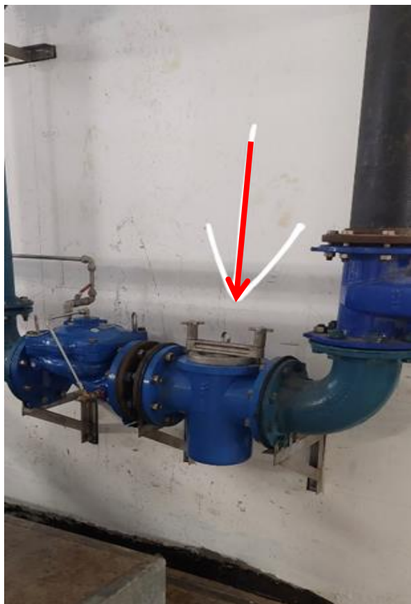
相片 1 及 1A – 過濾器設於每座樓的公用供水管測錶位附近
