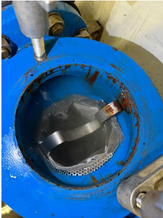
相片 2－ 打開過濾器的拆卸蓋
