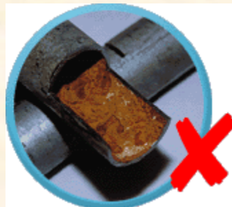
生鏽的無內搪層鍍鋅鋼管
