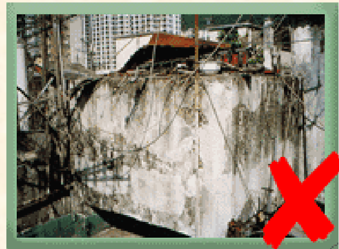
欠缺妥善維修、保養及管理的水箱
