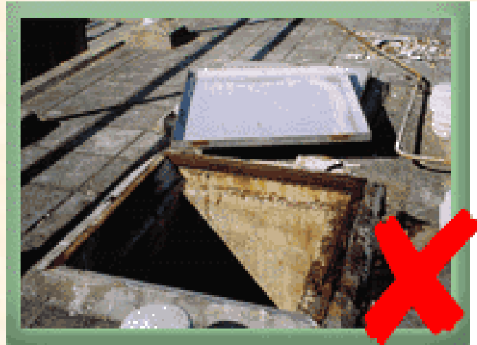
損壞、生鏽及沒有鎖的水箱蓋
