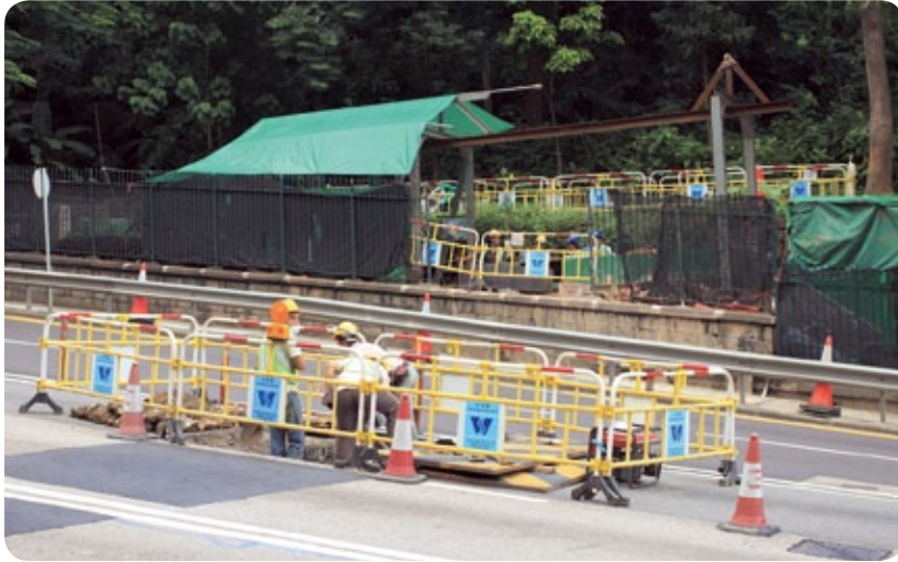
非開挖的施工方法能減低對路面交通造成影響。 Trenchless construction methods can reduce the impact on road traffic.
