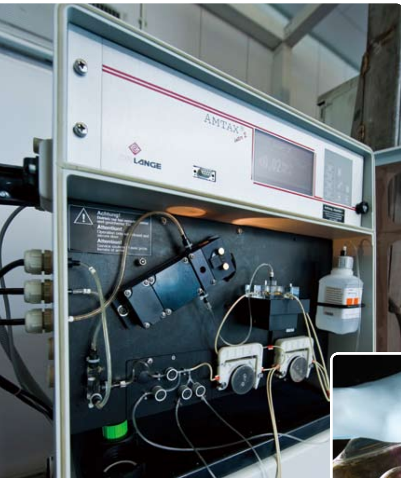
東江水質聯機監測系統。 Dongjiang Water Quality Online Monitoring System.
