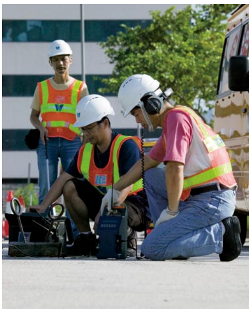
使用聲音測試儀去探測漏水位置。 Using noise correlator to detect water leak.
