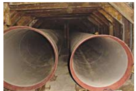
採用手挖隧道式無開掘方法於交通繁忙的道路敷設地下水管。 Using hand-dug tunnelling no dig method to lay water mains under busy road.
