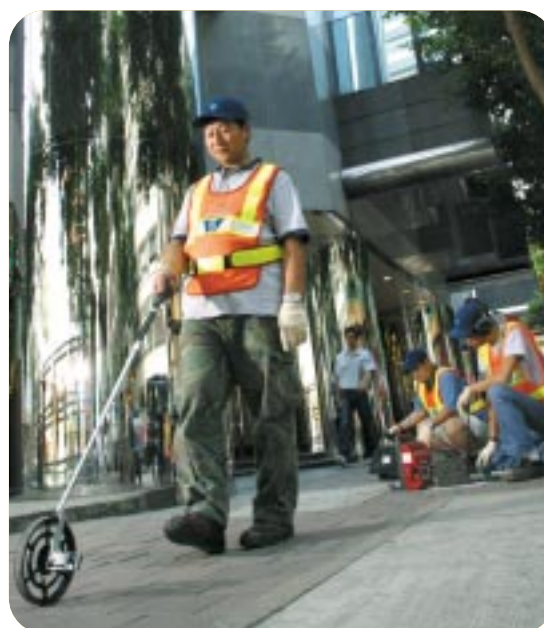
工作人員正進行地下水管滲漏檢測。 Staff conducting leak detection test on underground pipework.
