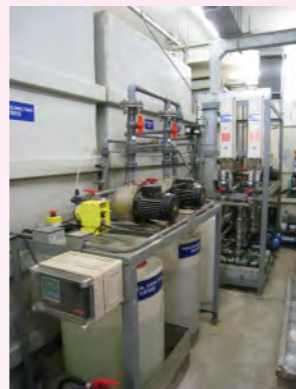
位於藍地街市公廁的污水處理及回用系統
