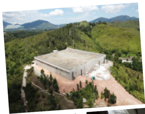
新建之桌山二號 食水配水庫
