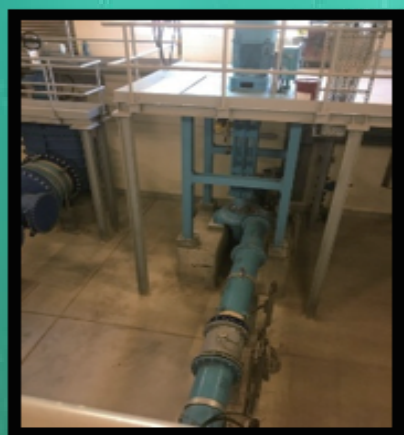
沙田瀘水廠的水力發電站
