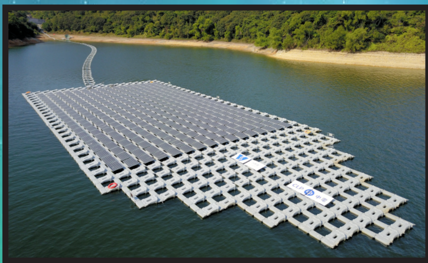
船灣淡水湖的浮動太陽能發電系統
