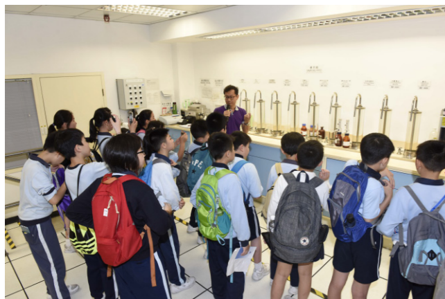
義工同事於控制室向到訪學生講解馬鞍山濾水廠控制室的設施
