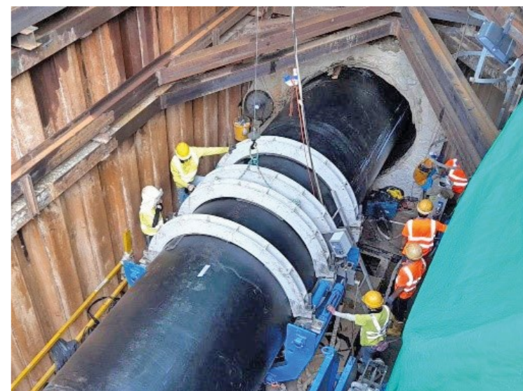
「上水及粉嶺東江水水管P4改善工程」運用「內套喉管法」，把新水管（聚乙烯水管）逐段推入舊水管內，形成修復後的水管
