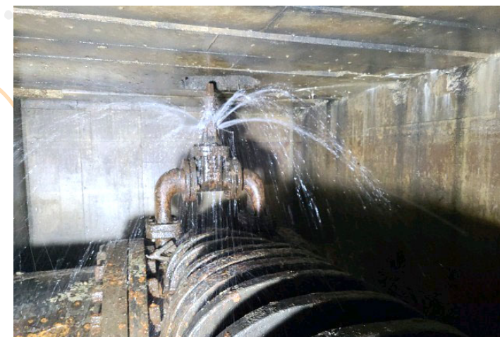
在新填地街一個150毫米直徑的旁道閘閥零件損壞並滲漏
