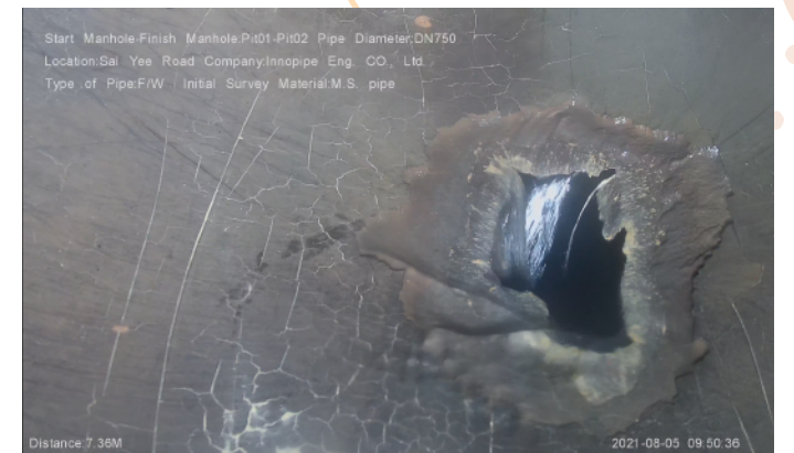
喉身破損位置
