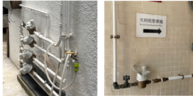
◆ 無線智能水錶於大澳的村屋（左）和公共屋邨安裝（右）。
