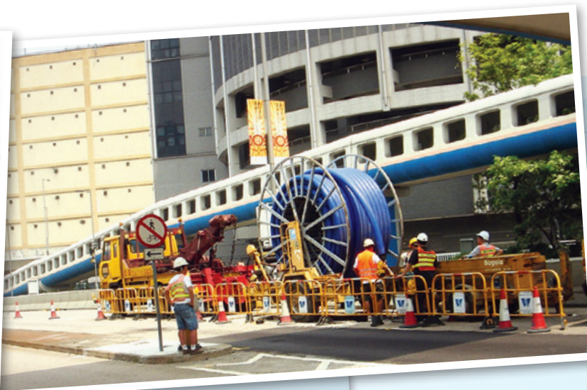
位於九龍灣的更換水管工程。 Water mains replacement works in Kowloon Bay.
