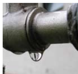
定期檢查家中水管有否滲漏
