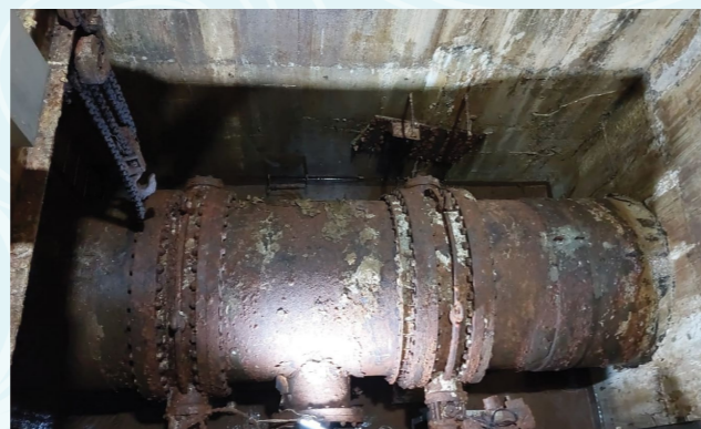
服務水務署超過半世紀的兩隻DN1600蝴蝶閥(未拆卸前)
