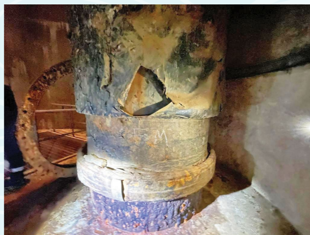
服務水務署超過半世紀的DN1600流量計(未拆卸前)
