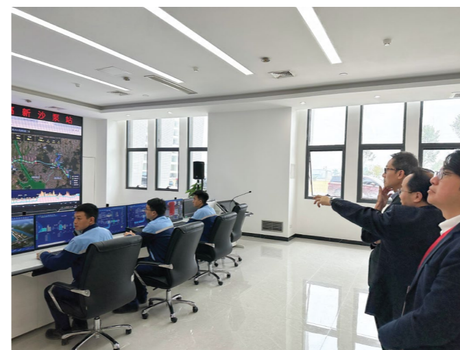
視察高新沙泵站控制中心
