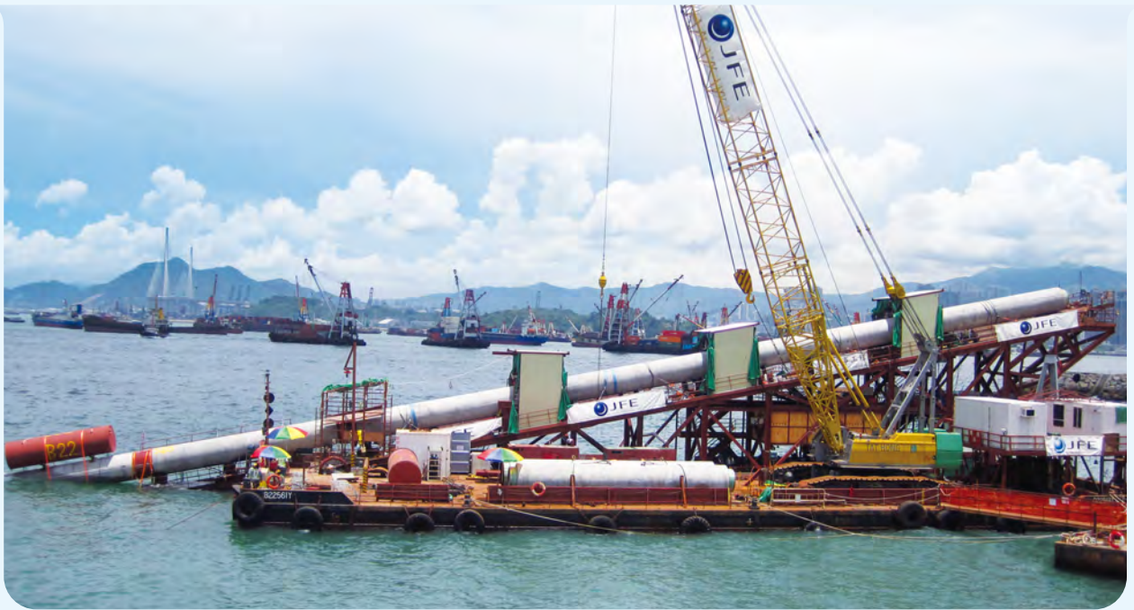
新的跨海食水海底水管將於2012年啟用。 The new cross-harbour fresh water submarine pipeline will be commissioned in 2012.
